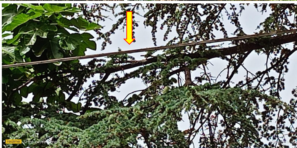
Come evidenziato dalle frecce in giallo i fili dell'alta tensione sono intrecciati tra i rami degli alberi alcuni anche secchi.
